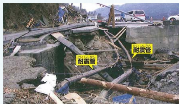
【東日本大震災の津波による道路崩壊の様子】
