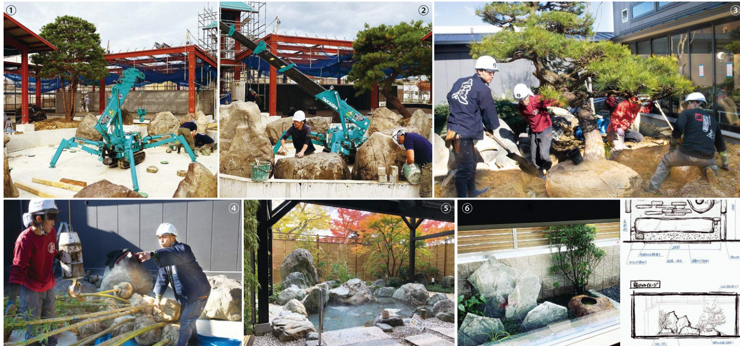
①②新たにオープンする源氏の湯の作業の様子。何も無い状態から大小様々な岩を並べて露天風呂を造り上げていく ③④松や竹などを植栽。庭の表情を決める重要な作業で、位置決めにもしっかり時間をかける ⑤⑥個人宅の庭も数多く手がけている。窓越しに見える様子を計算してイメージイラストに起こし、造り上げている
