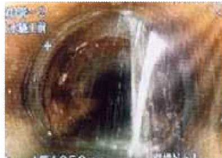
図 3-7 管路施設への浸入水※1
