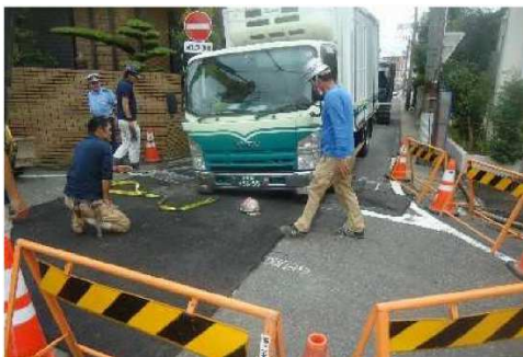
図 3-6 管路施設に起因した陥没事故※1
