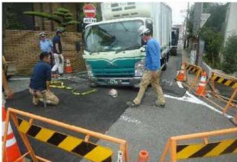
図 3-6 管路施設に起因した陥没事故※1
