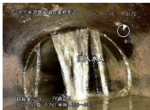
図5-4 管内の浸入水の状況例 （出典：出典：分流式下水道における雨天時浸入水対策計画策定マニュアル-2009年3月-、財団法人 下水道新技術推進機構、p48）
