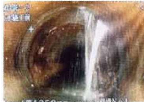
図 3-7 管路施設への浸入水※1
