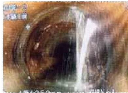
図 3-7 管路施設への浸入水※1
