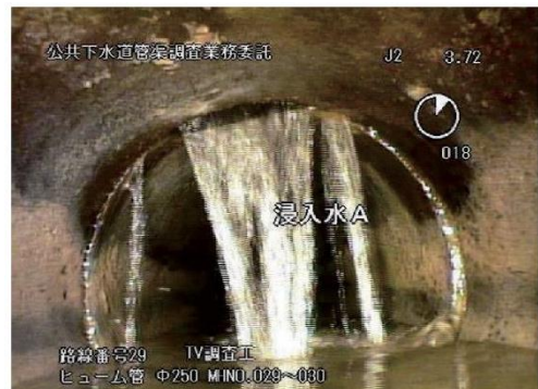
図 5-4 管内の浸入水の状況例
