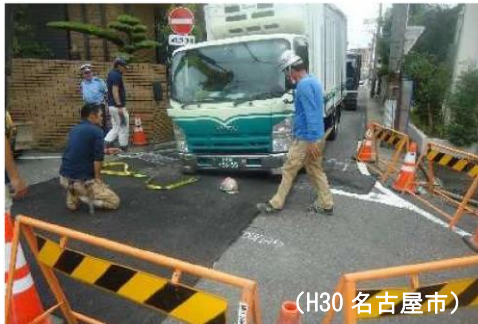
図 3-6 管路施設に起因した陥没事故※1
