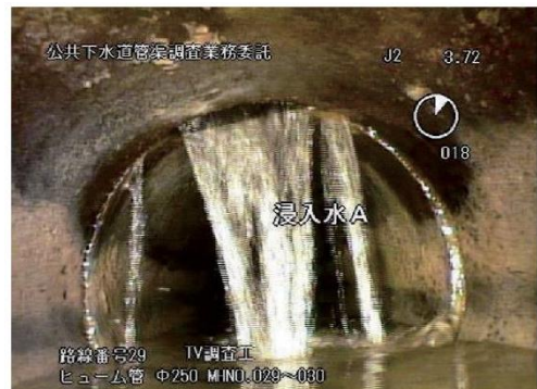
図 5-4 管内の浸入水の状況例
