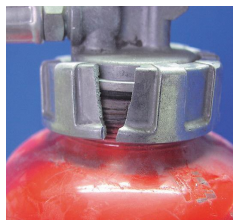
× キャップの破損
