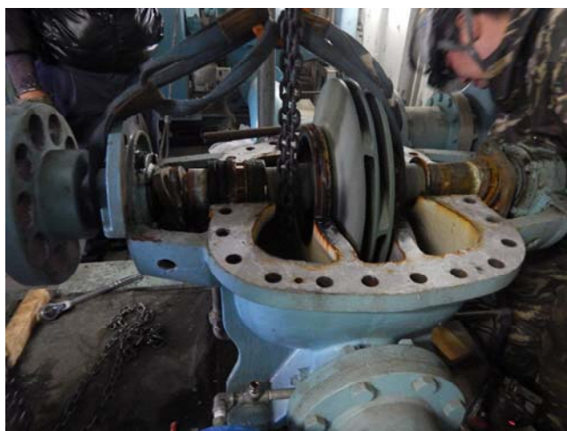
図 4-8 老朽化したポンプ
