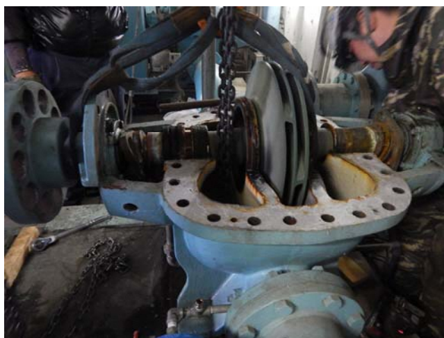
図 4-8 老朽化したポンプ
