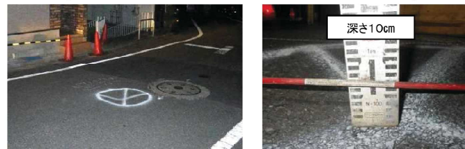
東京都北区での陥没事例(平成25年8月)
